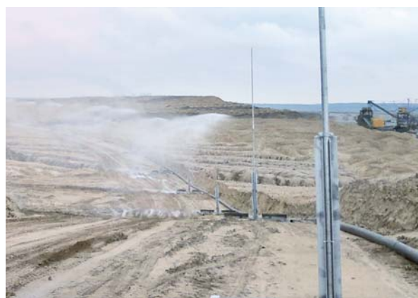
Deutlich länger als die Nebelkanonen sind die Sprühlanzen im Einsatz und haben sich an mehreren Tagebaurändern bewährt. Sie können problemlos mit dem geförderten Grundwasser gespeist werden. Lediglich eine Pumpe für den nötigen Wasserdruck ist erforderlich. Mit fortschreitendem Tagebau „wandern“ auch die Sprühlanzen-Galerien mit
