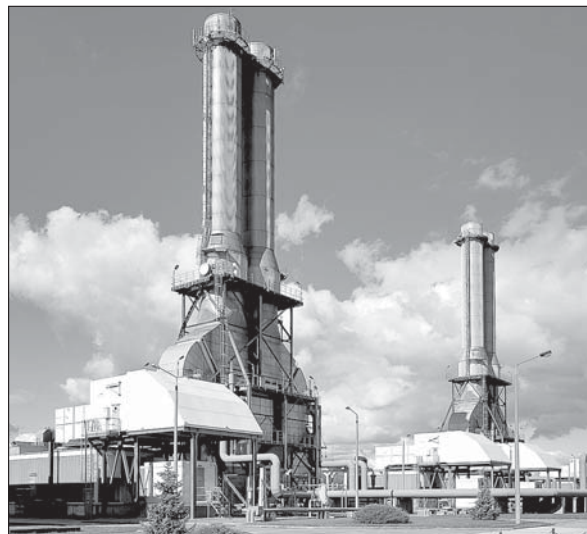
Im Spitzenlast-Kraftwerk in Ahrensfelde bei Berlin werden von der Schaltwarte aus alle vier Gasturbinen-Kraftwerke von Vattenfall zentral gesteuert, die Stromlieferzeiten verkürzen sich dadurch enorm Foto: Vattenfall/Chr. Bedeschinski
