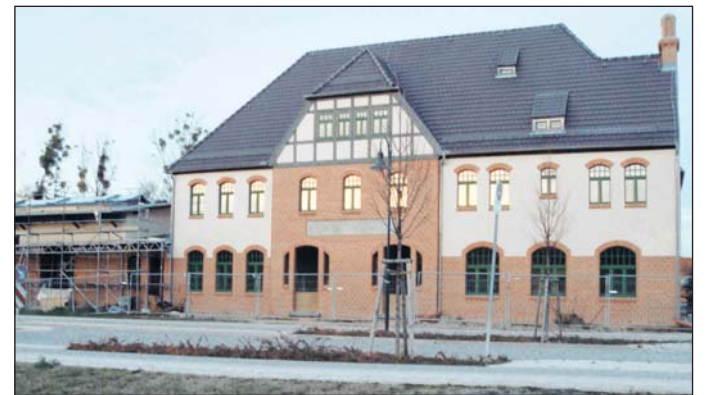
Der Bahnhof bleibt in diesem Jahr wichtigste Baustelle des Vereins. 2010 soll das „Zentrum für Tourismus und Kultur am aktiven Tagebau“ mit Leben gefüllt werden. Hier sollen sich Touristen informieren können, Touren buchen, sich stärken. Aber auch eine „Tourismus-Schmiede“ und Gästeführer-Schule sollen hier untergebracht werden
