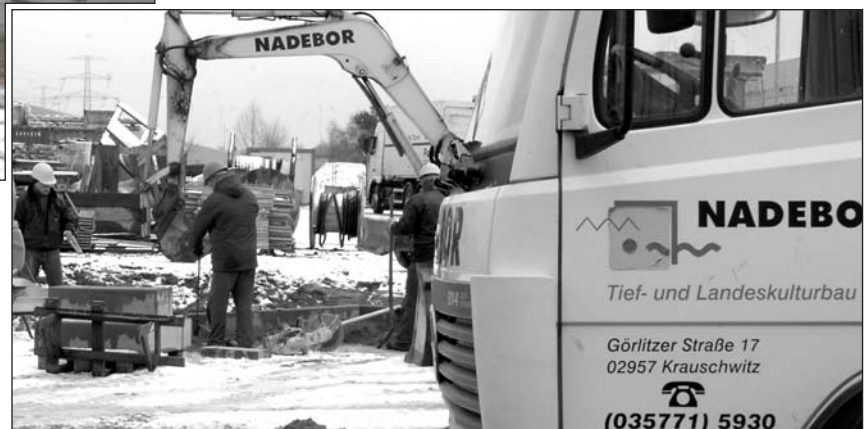
Überall auf der Baustelle sind Firmenfahrzeuge aus der Region zu sehen. Über 60 Prozent der Firmen zeigen uns bekannte Nummernschilder. Zu den Stoßzeiten arbeiteten hier über 300 Menschen gleichzeitig - eine logistische Meisterleistung der Bauleitung
